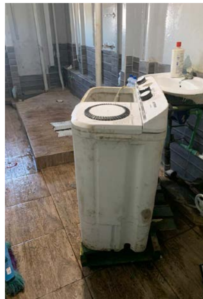
Pokvarena perilica i probušena vodoinstalacija iza nje
